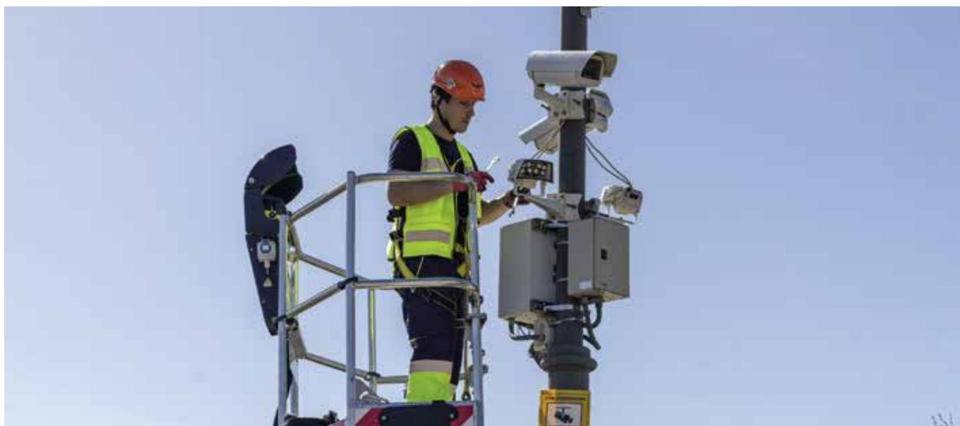
Instalación de cámaras de seguridad
