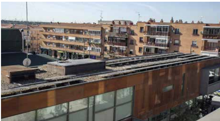
Placas fotovoltaicas en el centro María de Vera
