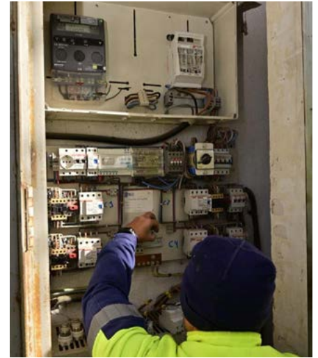
Operario manipulando el sistema de telegestión
