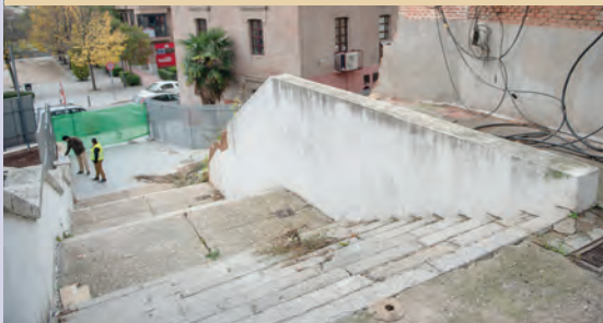
Consolidación del muro de contención y ampliación de la escalera de acceso a la calle Buenavista
