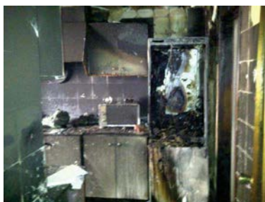
DAÑOS EN EL CONTINENTE
